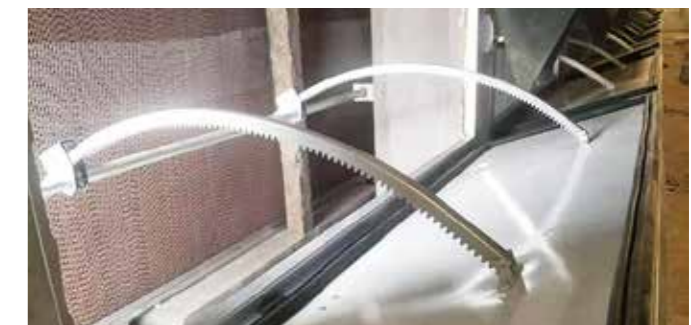
Tunnel Door R&P System
